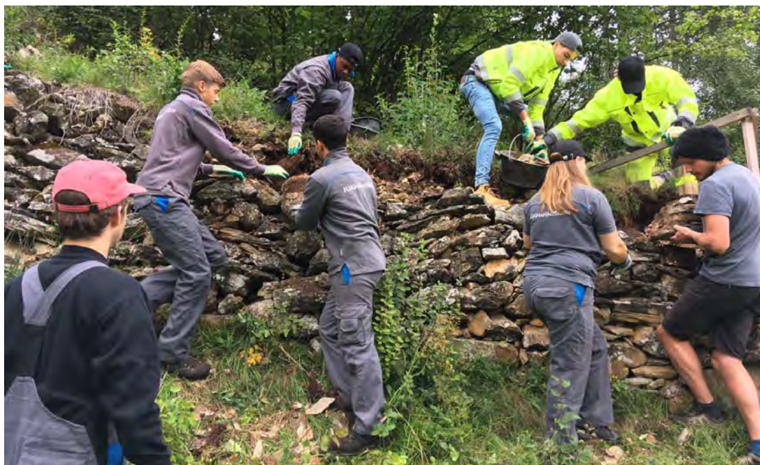
Abb. 8: Auszubildende der Flughafen Zürich AG bei der Arbeit an der Trockensteinmauer in Tarasp
